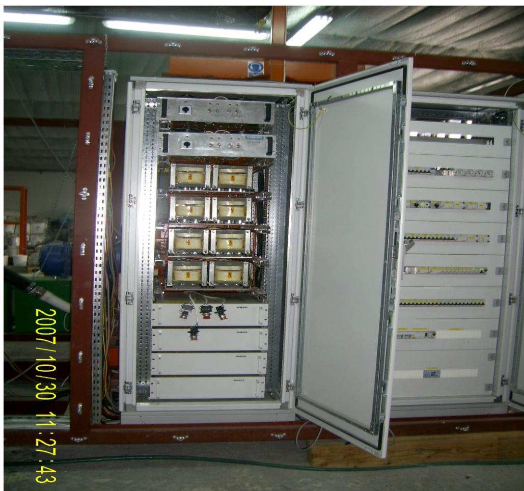
Ryc. 25 Montaż szafy sterowniczej reaktora ATON 200- optymalizującej przebieg procesów oraz zużycia energii elektrycznej
